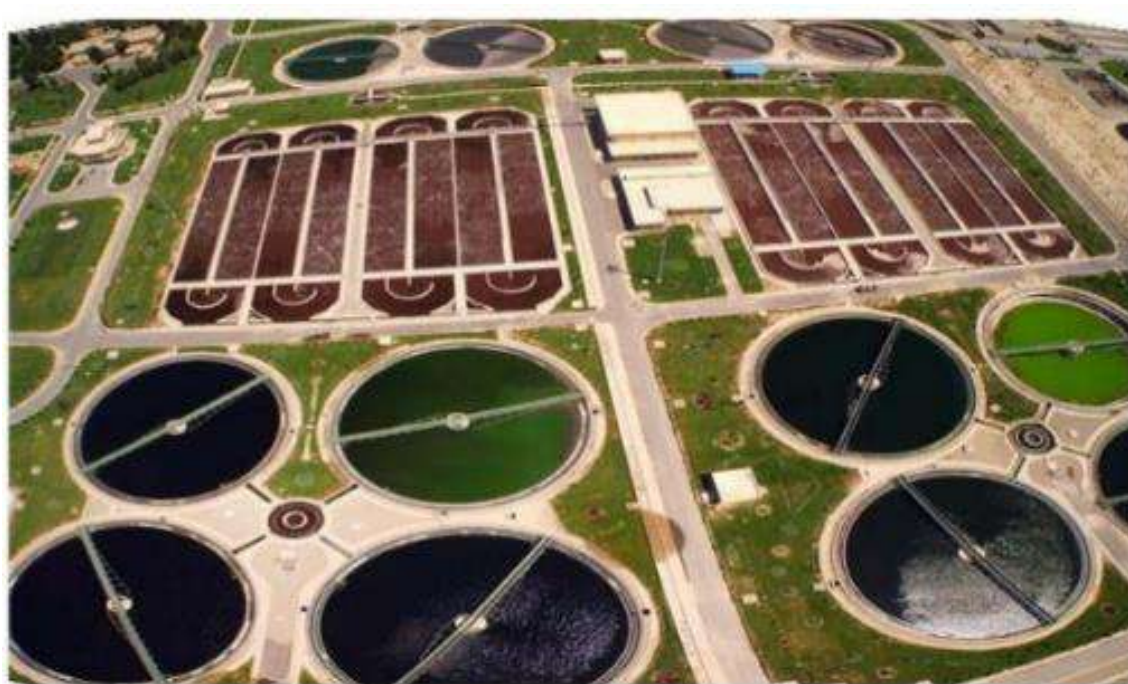
شکل ۴- نمای مدول‌های ۵ و ۶ تصفیه‌خانه فاضلاب جنوب تهران
