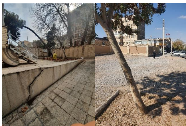
شکل ۲- نشست سازه در اثر ترکیدگی شبکه توزیع آب و کج‌شدن درختان
