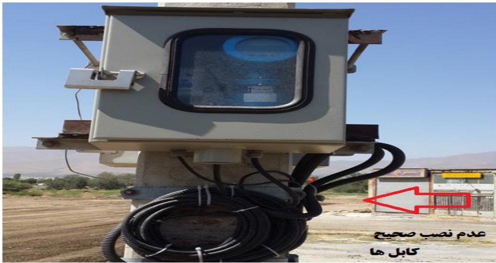
شکل ۲- عدم نصب صحیح کابل نمایشگر دستگاه فلومتر الکترومغناطیسی (فلومتر DMA ورودی شهرک فرهنگیان شهر همدان)
