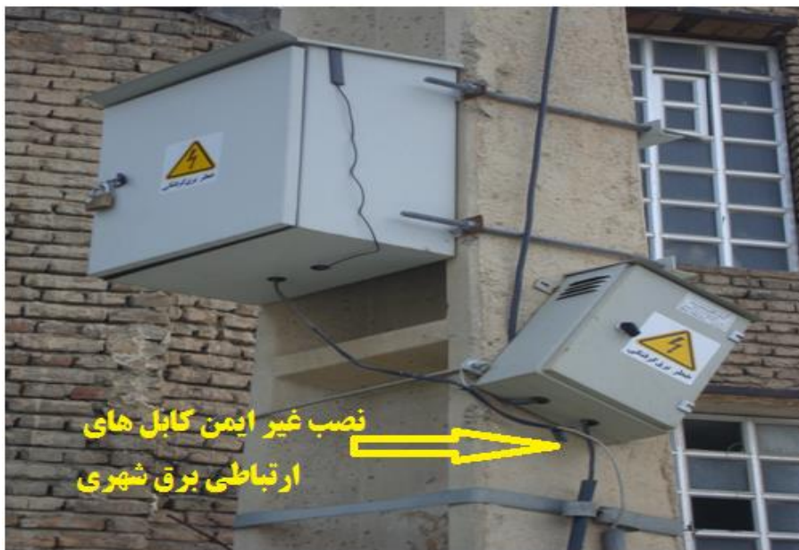
شکل ۴- نصب غیر ایمن و بدون محافظ کابل‌های ارتباطی تابلوی دستگاه کنترل گر فشار شکن و برق شهری
