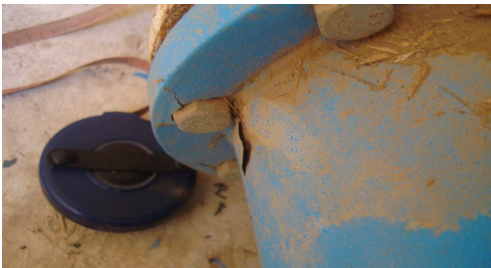
شکل ۳- کیفیت نامناسب سنسور و نحوه نامناسب نصب سنسور فلومتر الکترومغناطیسی
