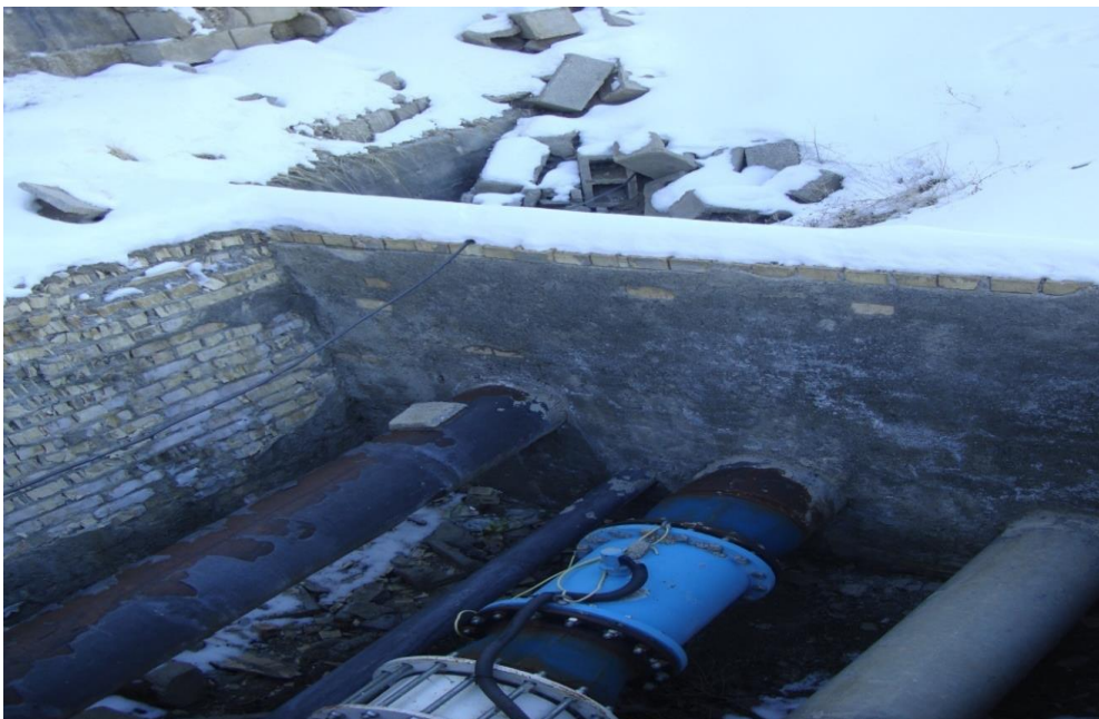
شکل ۲- ساخت منهول نامناسب فلومتر الکترومغناطیسی (منهول بدون دال است)
