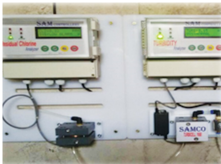
شکل ۲- نمایی از تابلو سیستم
