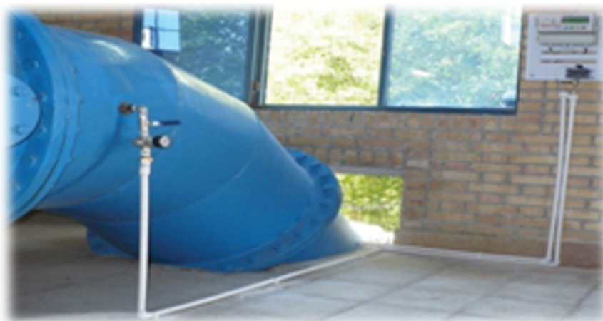
شکل ۴- محل نصب آنالایزر در تصفیه‌خانه‌های شرکت آب و فاضلاب استان تهران
