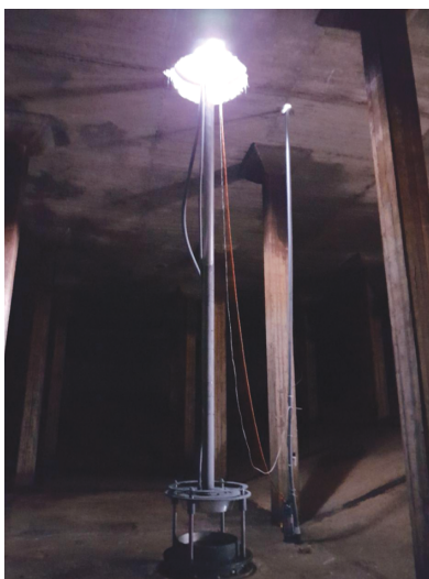
شکل ۳- محل نصب شیر در مخزن
