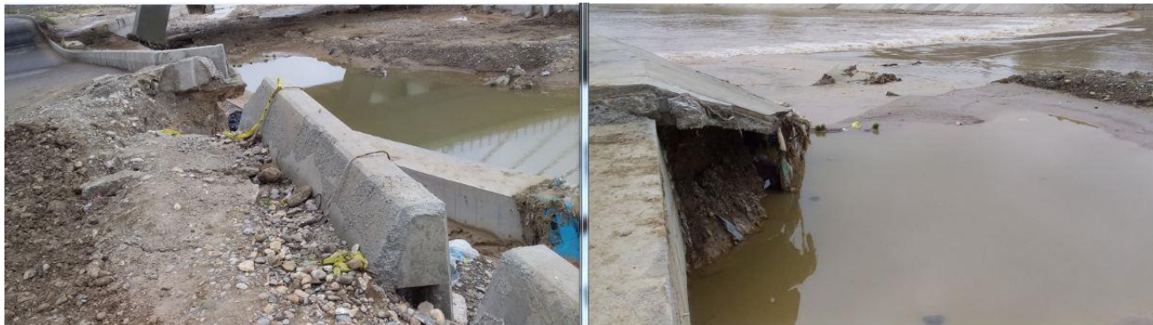
شکل ۱۱- تصاویر مربوط به آبخستگی‌های دیواره بتنی و تخریب جدول‌های بتنی در بالادست سد لاستیکی بعد از وقوع سیل
